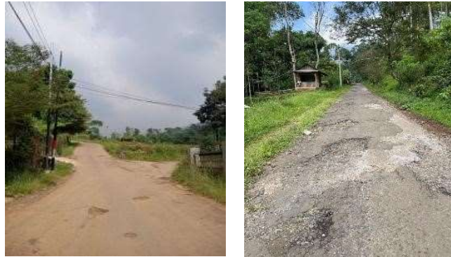
Gambar 6. Kondisi Jalan di Desa Wisata Lamajang
