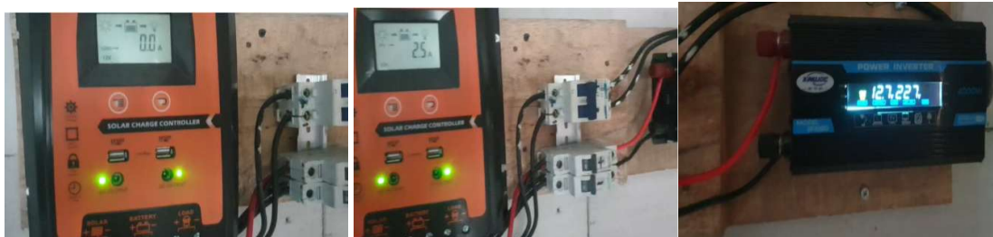
Gambar 9. Aliran listrik dari pembangkit listrik tenaga surya sudah mulai berfungsi
