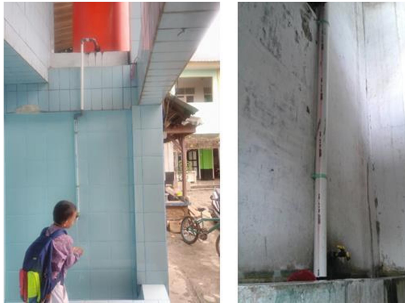
Gambar 7. Air Hujan yang Tertampung digunakan Sebagai Air Wudhu dan Kebutuhan Toilet
