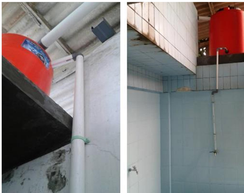
Gambar 6. Instalasi Perpipaan pada Sistem Panen Hujan
