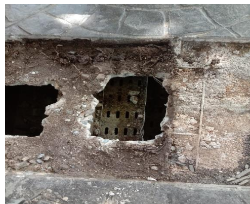
Gambar 3. Saluran utilitas pulau Penyengat Sumber foto : Penulis.
